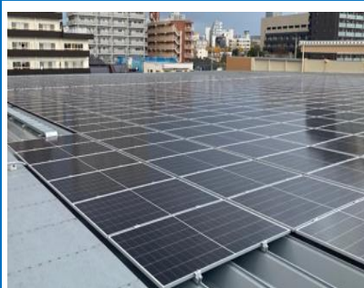
太陽光パネル
