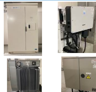
上段：パワーコンディショナー/下段：変圧器
