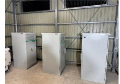
定置用蓄電池
