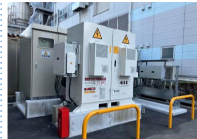
定置用蓄電池
