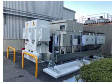
パワーコンディショナ/監視装置
