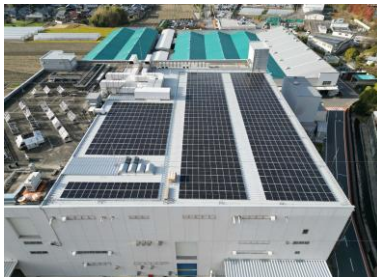
太陽光パネル
