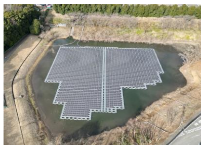
太陽光パネル (調整池に設置)
