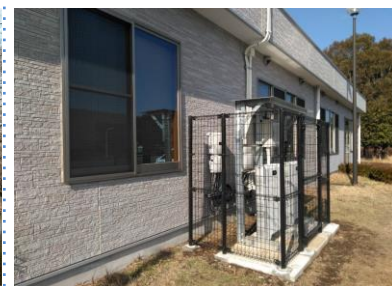
定置用蓄電池
