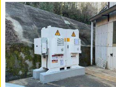
定置用蓄電池
