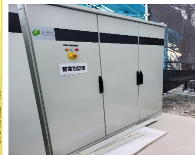
定置用蓄電池
