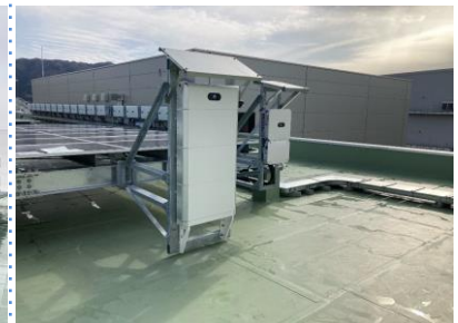
定置用蓄電池
