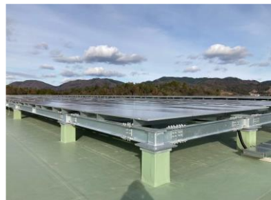
太陽光パネル
