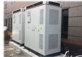
定置用蓄電池
