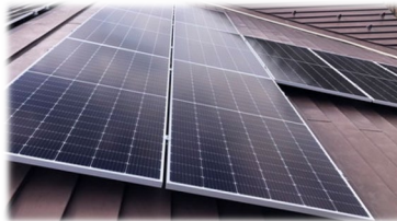
太陽光パネル
